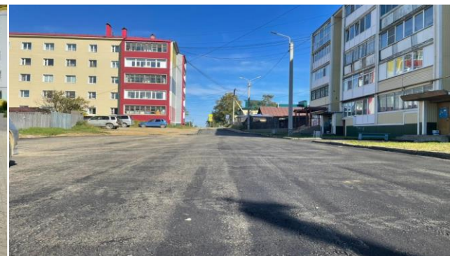
Ямочный ремонт территорий многоквартирных домов, общей площадью 1 157 кв. м в пгт. Ноглики
